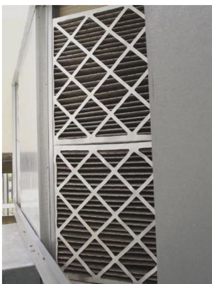
De cima p/ baixo: unidades de tratamento do ar de renovação, bombas primárias e secundárias, isolamento dos dutos, recuperadores de calor
